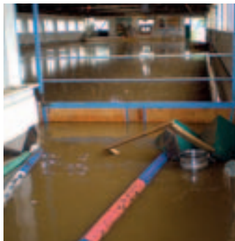
Die Reithalle als „Schwimmbad“
